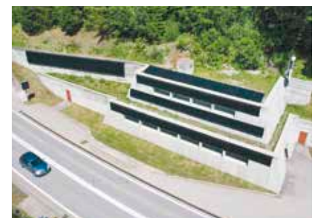
PV-Anlage Tunnelportal Trin (Foto: TBA GR)
